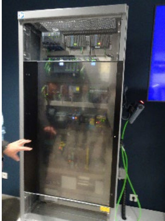
図1：ロボットを生産現場でセットアップして IT につなぐための制御盤 注) 最上段に設置されているのが産業用 PC で二段目に設置されているのが PLC 出所) IMPULSE において筆者撮影。
