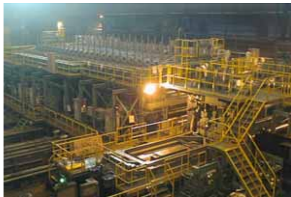
写真1 厚鋼板の新加速冷却設備の概観
