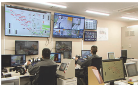
廃炉関連事業操作室
