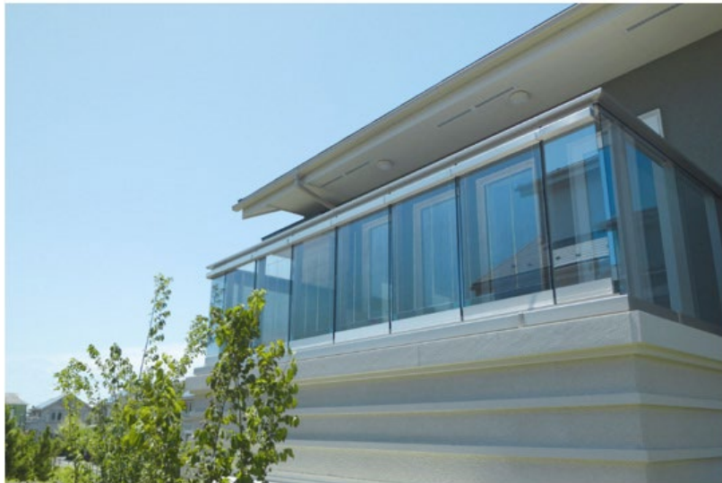
図 5-10 PSC を使用した BIPV ガラスのバルコニーへの設置の様子
